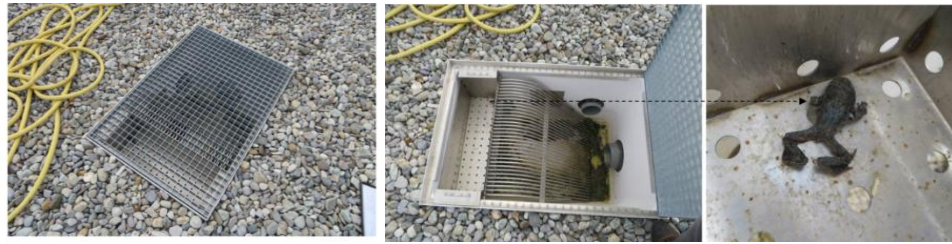
Figure 7 : Exemple d'un bac de dégrillage constituant un piège pour les amphibiens et reptiles, neutralisable par la pose d'un grillage à maille fine
